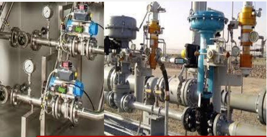
Instrumentación de válvulas
